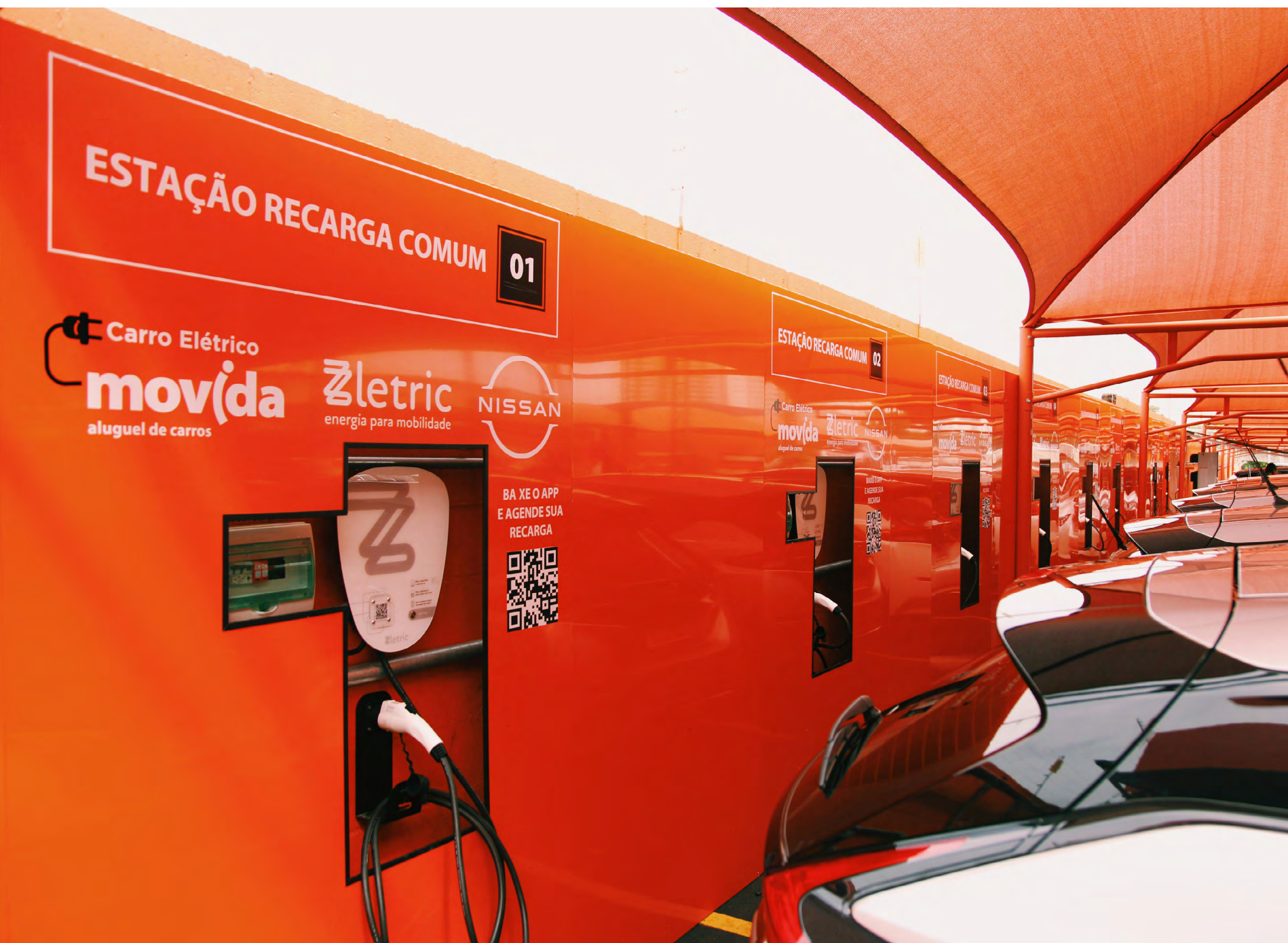
Estação de recarga para veículos elétricos | Movida
